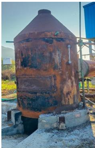
a. Boiler Unit
