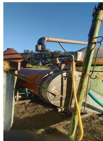
b. Condenser Unit
